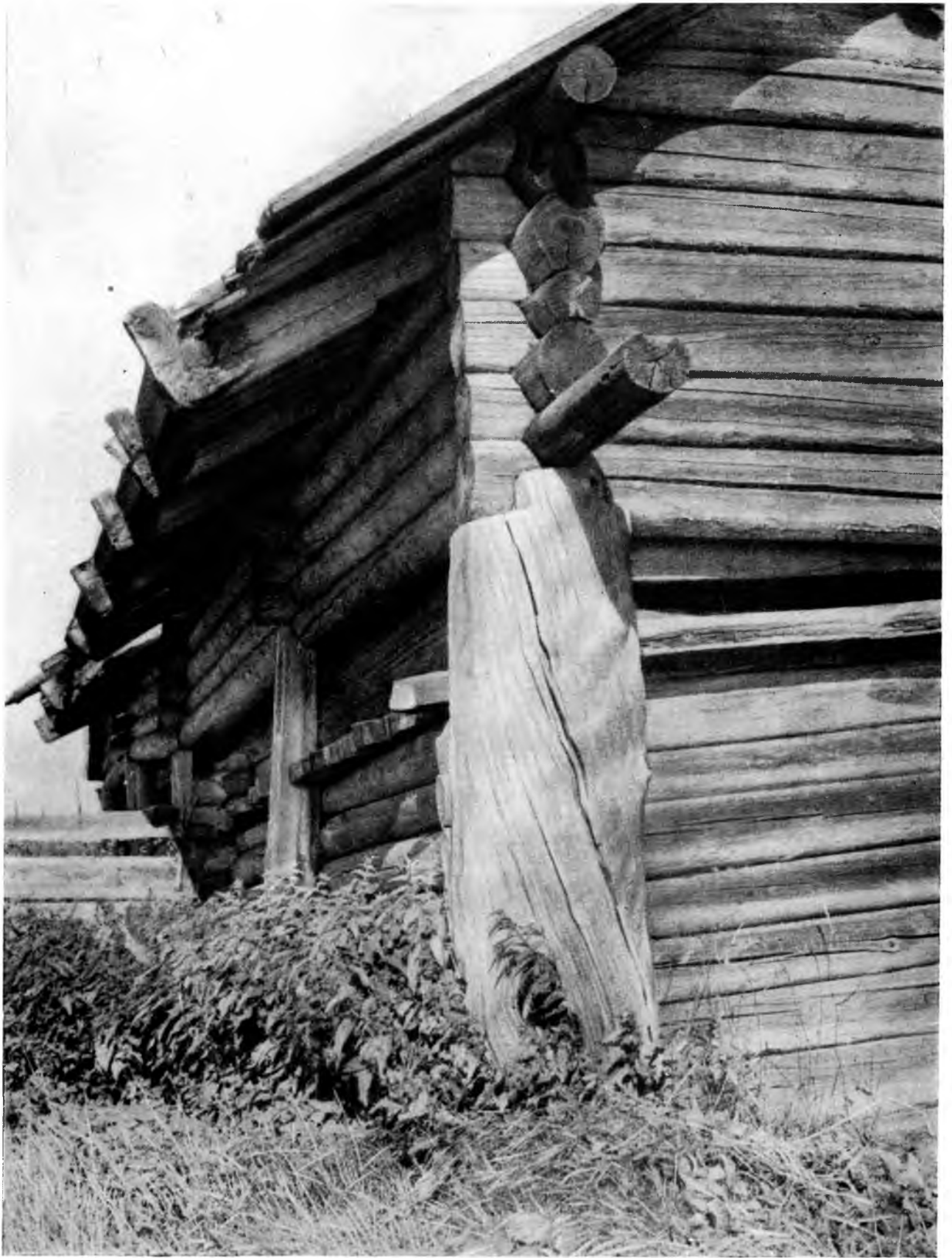
Фот. 125. Конструкция угловой опоры двора в селе Сычи Заонежского района Карельской АССР.
